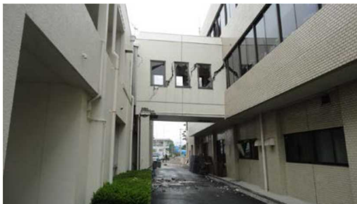
庁舎における構造部材の損傷
