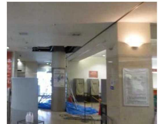
病院における天井の損傷
