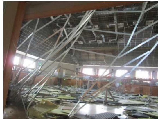
体育館における天井の損傷
